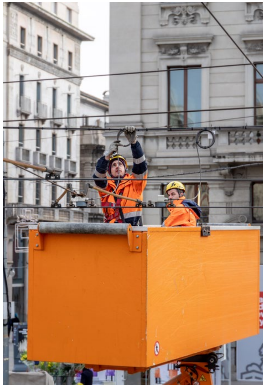
Enrico Piana e Nicola Abazia, trabattellisti. Enrico Piana and Nicola Abazia, overhead lines technicians.
