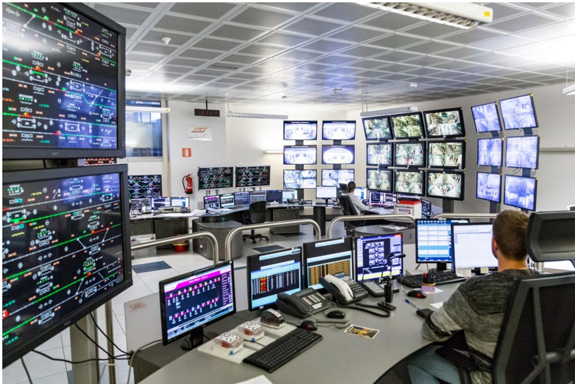
Sala operativa della linea Lilla, all'interno del deposito dei treni in viale Fulvio Testi. The Purple line control room, inside the train depot on viale Fulvio Testi.
